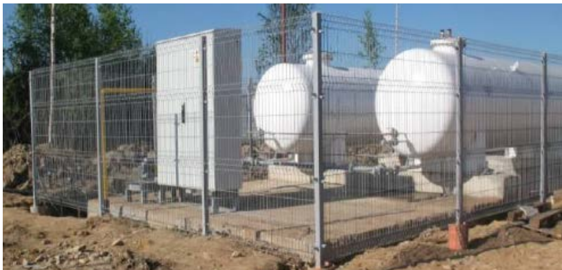
Рис. 1.10. Общий вид системы автономного энергоснабжения СУГ из двух резервуаров геометрическим объемом 12 \text{ м}^3 каждый
